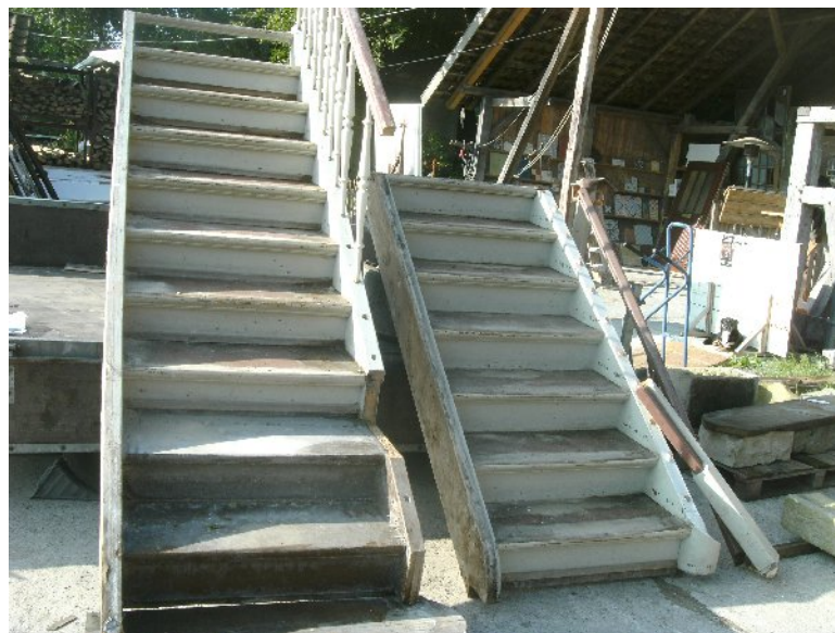
Teil I = 11 Stufen + Teil II. = 7 Stufen - Treppenbreite: ~ 97 cm Stufen aus Eiche – Wangen aus Weichholz
